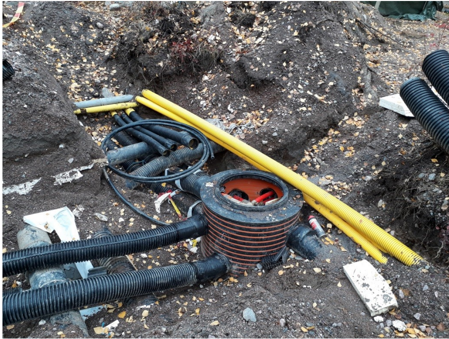
Kuva 6. Risteäviä putkia ja kaapeleita (Riikonen, 2019)
